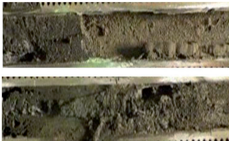
FIGURA 3. Tubos del intercambiador de calor bloqueados debido a alta acumulación de depósitos
